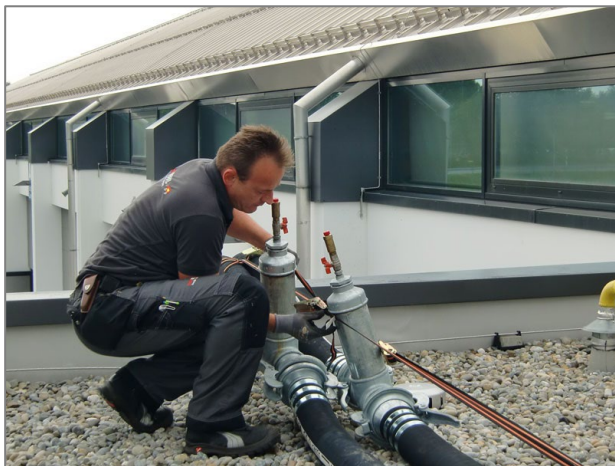
BU: Hotmobil-Servicetechniker kümmern sich um die Auslieferung und Inbetriebnahme der mobilen Kälteanlagen. (Bildquelle: Hotmobil Deutschland GmbH, Datei: 2021-PM-Hotmobil-Mietkaelte-2.jpg )
